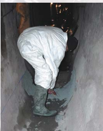
Application de la résine ou du ciment colle sur une épaisseur de 4 à 6 mm avant la pose des lès d'ID Seal
